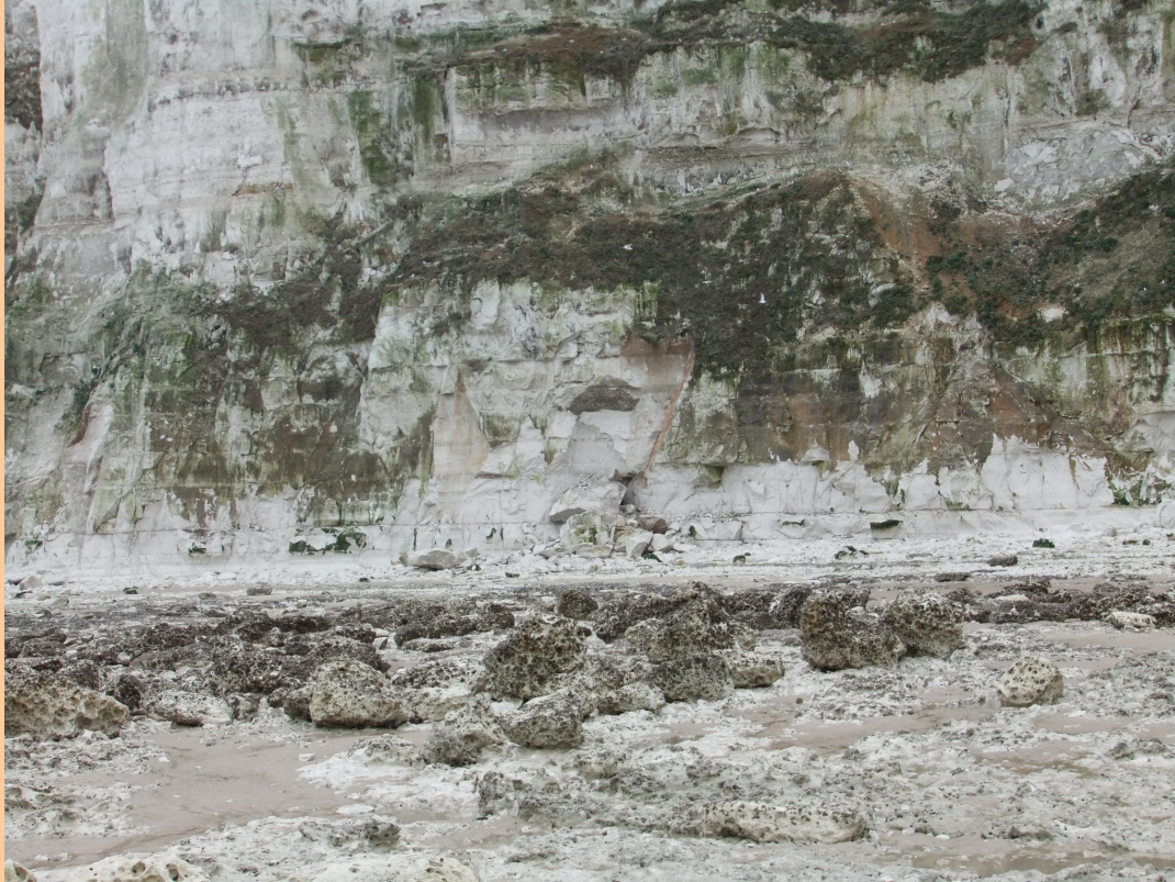
Illustration 23 : Détail du pied de falaise du Tréport attaqué par la mer à chaque marée (Source : CETE NP)
